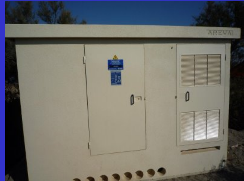
Un poste de livraison raccorde le réseau public haute tension (20 000V) aux équipements électriques privés basse tension (400V).
