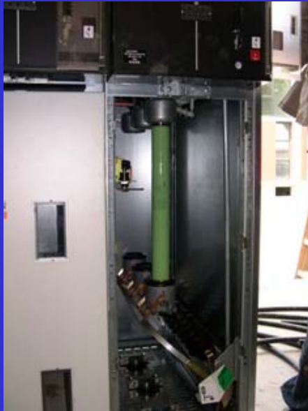
Fusibles hautes tension dans la cellule interrupteur- fusible
